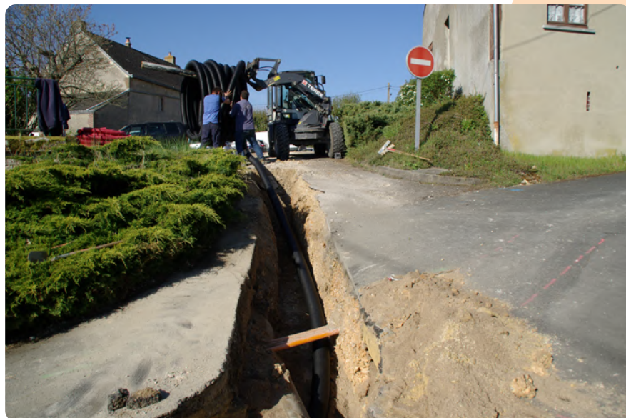
Travaux d'installation du chauffage par géothermie dans la commune de Saunay (© Mairie de Saunay)
